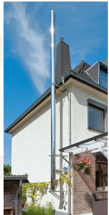
Rookkanaal buiten de woning
